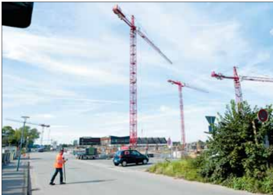
Die Güteramtsstraße im künftigen Stadtteil Bahnstadt wird seit gestern ausgebaut. Rechts nebenan haben die Arbeiten für „Campus II“ schon längst begonnen. Foto: Stefan Kresin
